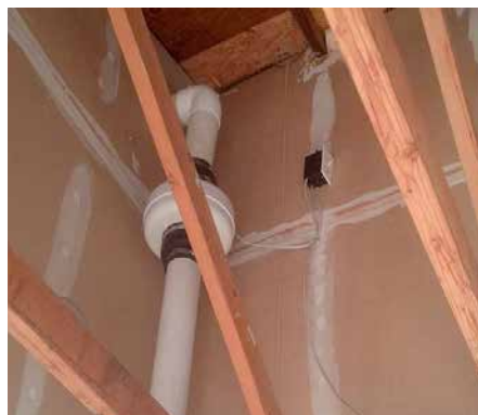
Εικόνα 5. Στην αγορά υπάρχουν διαθέσιμες δοκιμασμένες τεχνικές για περιορισμό της συγκέντρωσης ραδονίου στα κτήρια
